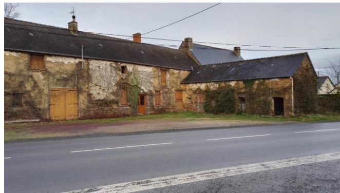
Longère agricole au nord-ouest n'ayant plus d'usage en face du verger le long de la RD125 en entrée de ville
