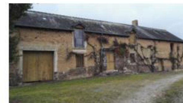
Longère agricole « La basse ville au manoir » dans le secteur sud du périmètre d'étude ayant un usage de stockage. Le projet prévoit l'aménagement d'un tiers-lieu dans cette longère en raison de son caractère central
